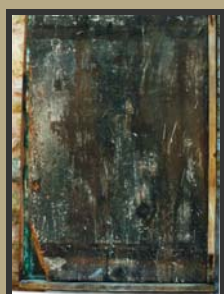
1. Φθορές στον ξύλινο φορέα
